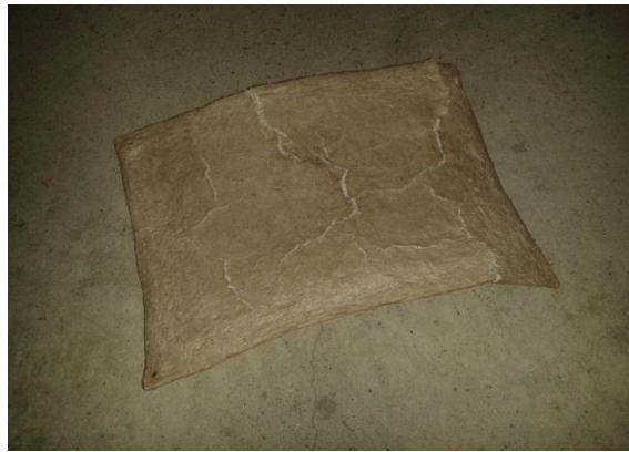
Figura 29. Panel seco con daños en la parte central.
